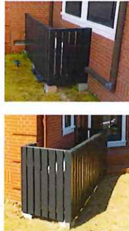
エアコン室外機
